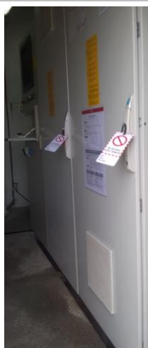
Puertas bloqueadas, impidiendo así el acceso a los sistemas de apertura de la circuitería de Rotor y Estator.
