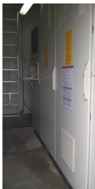
Armario ground. El primer módulo corresponde al Estator y el modulo central al Rotor.
